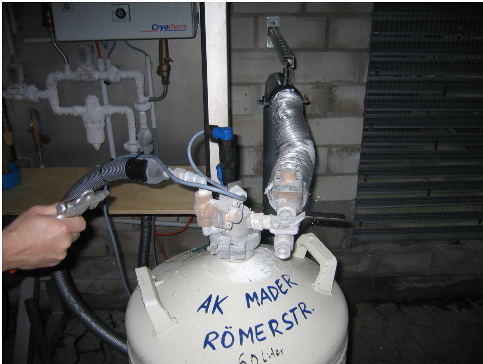
Abb.6: Enteisen des Abfüllkopfes mit Pressluft.
